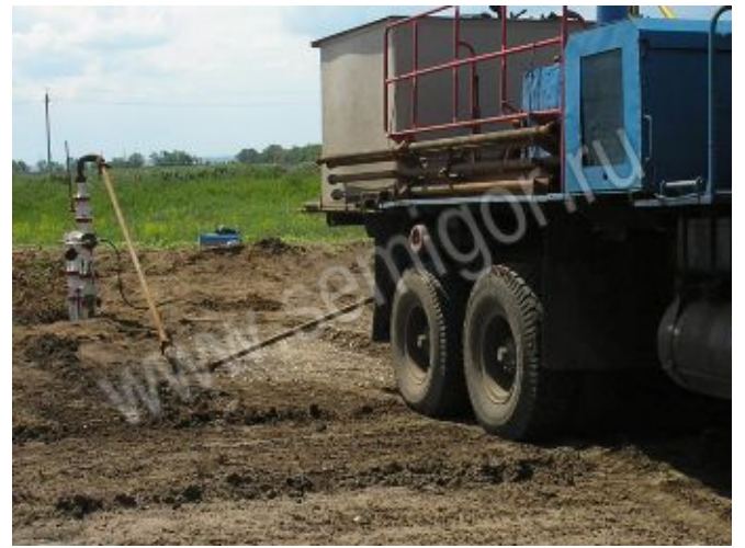
Резервный насос ЦА-320 готов к работе
