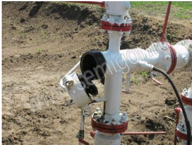
Стационарная камера запуска очистного поршня
