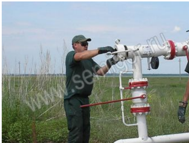
Стационарная камера приема очистного поршня
