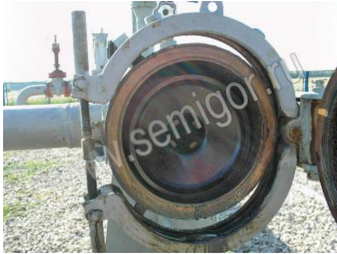
Очистной поршень Семигор-3Д1М-273 внутри камеры запуска.
