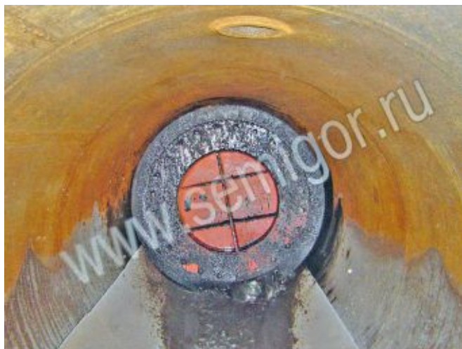
Поршень полиуретановый (манжетный) Семигор-М4-С-1420 (вид спереди) пришел в камеру приема очистных поршней (ПК 10 ООО "Газпром трансгаз Югорск"). Перед поршнем "вынос" из очищенного участка газопровода
