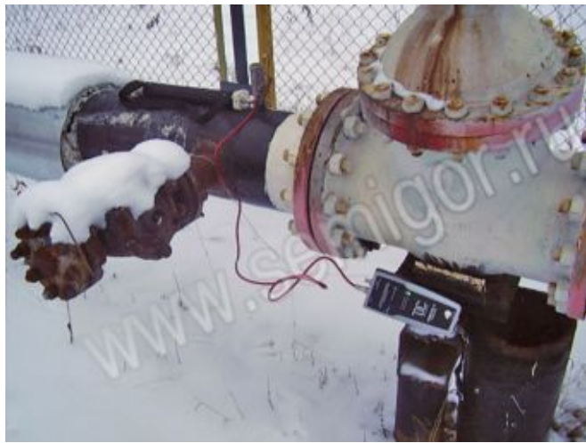
Приемник Семигор-Р на контрольной точке (узел задвижек) зафиксировал прохождение очистного поршня Семигор-4Д1М-С-273 оснащенного передатчиком Семигор-С-80-Б. Диаметр трубопровода 273 мм, толщина стенки 10 мм, температура воздуха -19 °С
