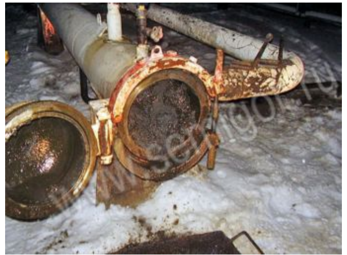
Очистной поршень Семигор-4Д1М-С-273 оснащенный передатчиком Семигор-С-80-Б пришел в камеру приема очистных устройств (узел подключения № 37 Фаинского месторождения)
